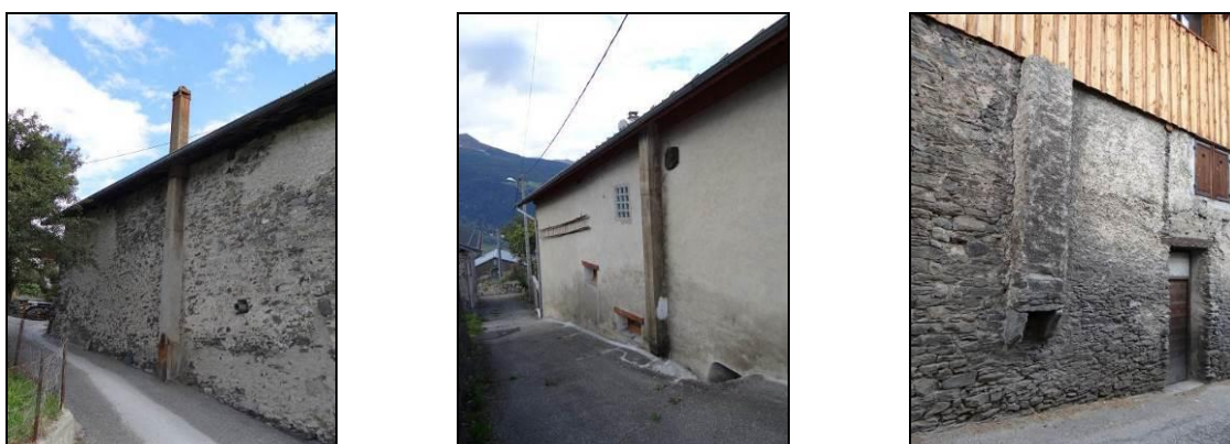
Photo 48 : Échantillon de conduits de cheminée extérieurs
