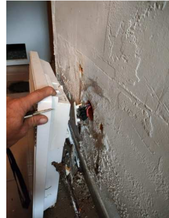
Infiltration eau depuis des mois Montorlin (Biens du revers)
